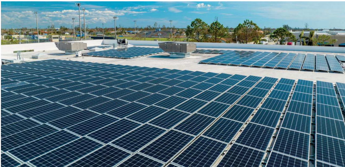
Les panneaux solaires installés sur les locaux tertiaires permettent de bénéficier d'une énergie inépuisable. Photo groupe SGE
